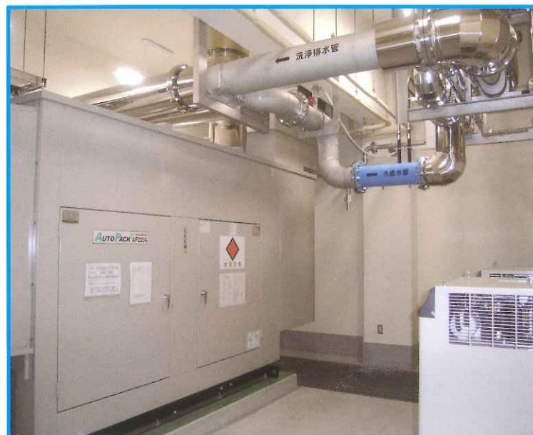
⑤発電機室
