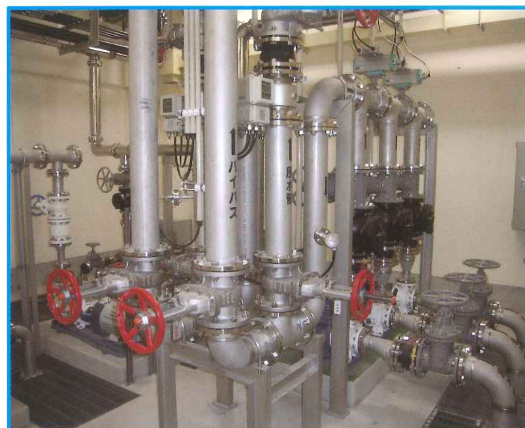
⑥ポンプ室
