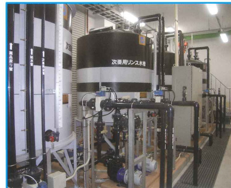
②薬品洗浄室
