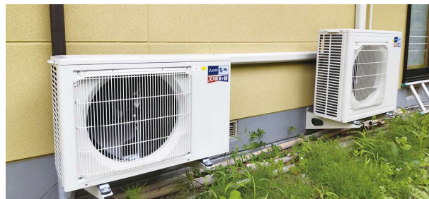
エアコンの室外機
