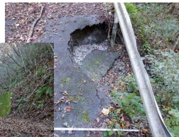
路面沈下の未、路肩が欠損
