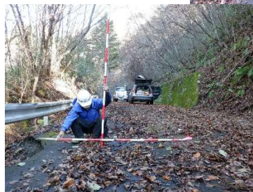
路面が10cm沈下
