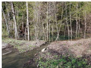
横断暗渠が目詰まりして、路面へ流れ下る渓流水（暗渠管は5m下）
