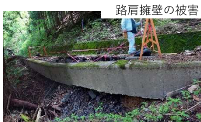
路肩擁壁の被害
