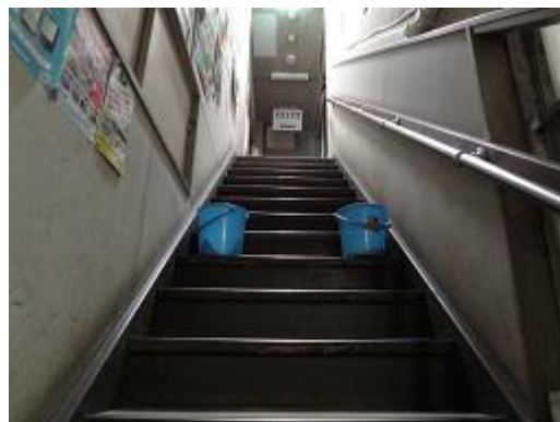
役場庁舎 雨漏り
