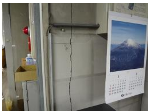
役場1F 柱クラック
